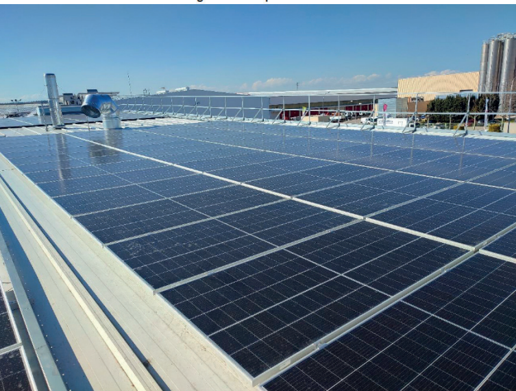
Vista general Campo Fotovoltaico
