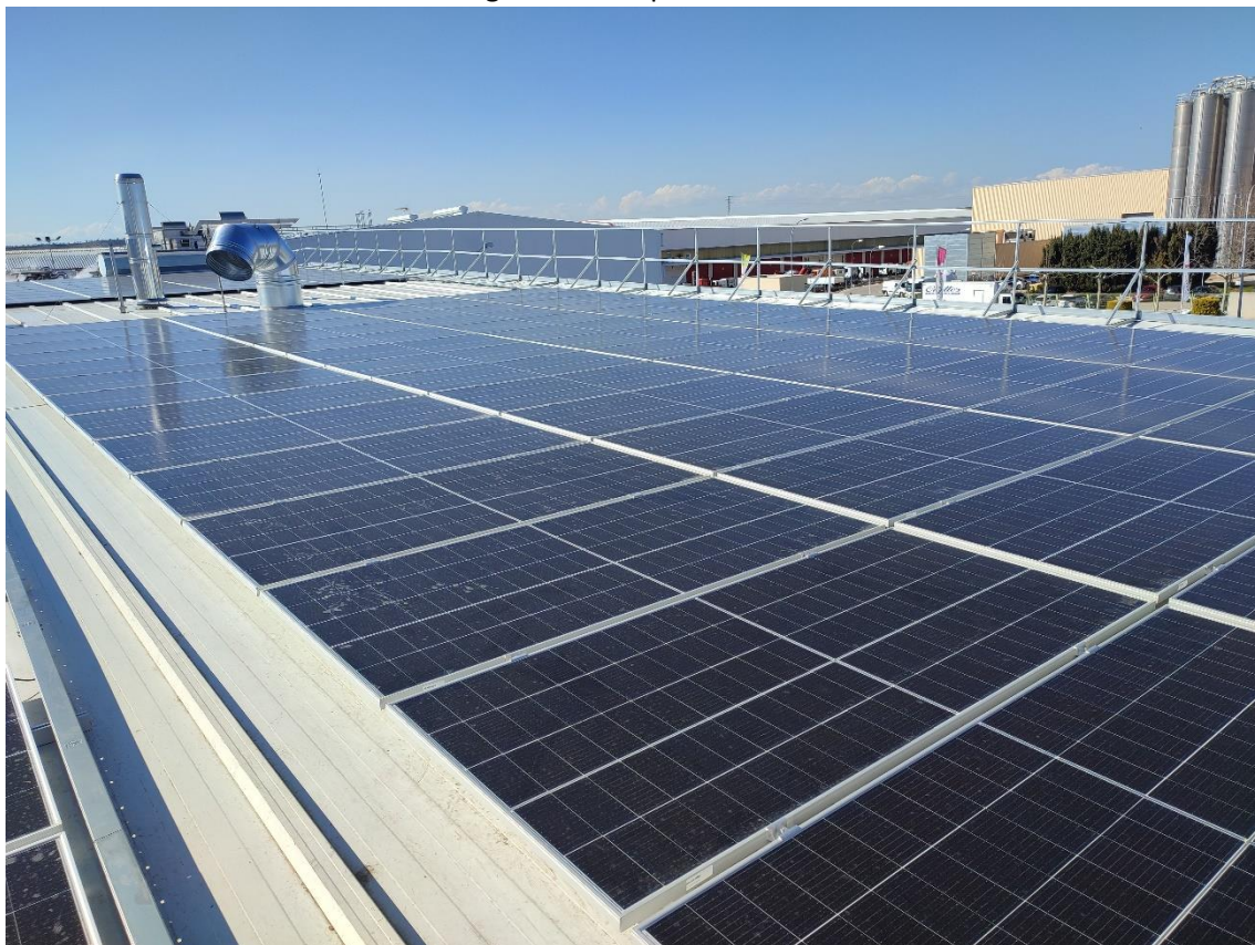
Vista general Campo Fotovoltaico
